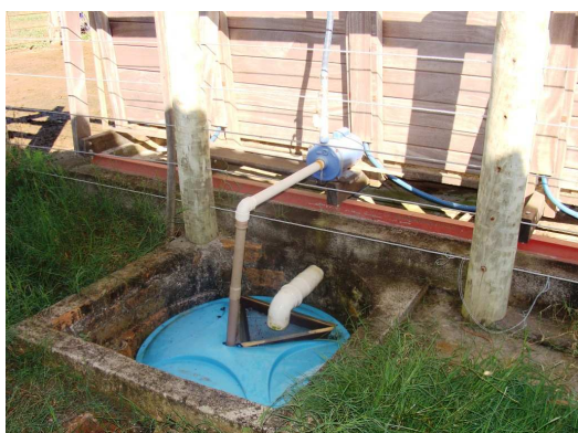
Figura 8. Câmara Atomizadora. Detalhe do reservatório e motobomba.
