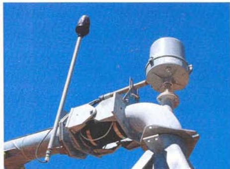
Comando elétrico das torres do pivô
