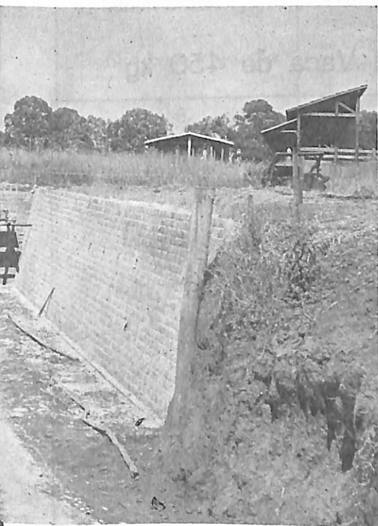
de um silo trincheira.
