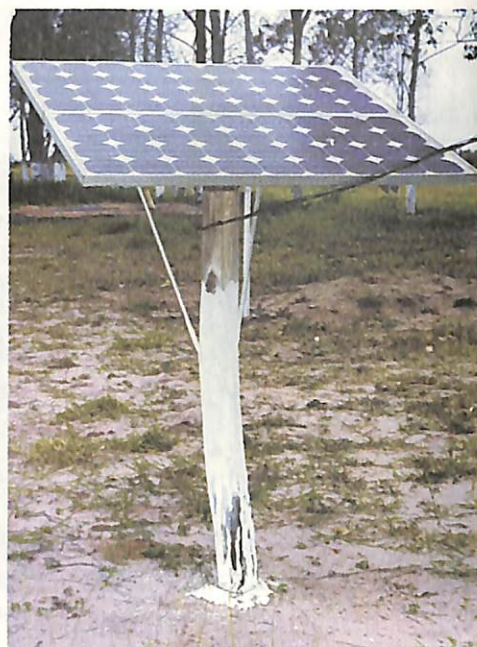
Painel solar: para radiocomunicação em fazenda sem energia elétrica
