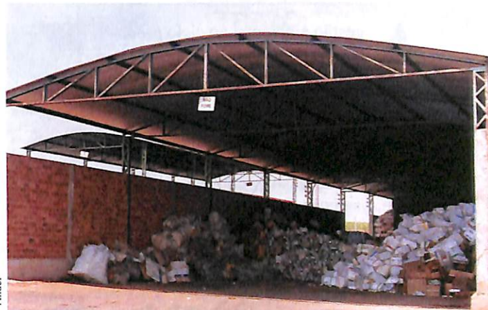
As centrais e postos estarão funcionando perfeitamente em, no máximo, cinco anos
