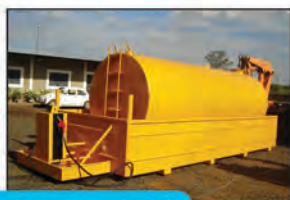
Tanque aéreo combustível
