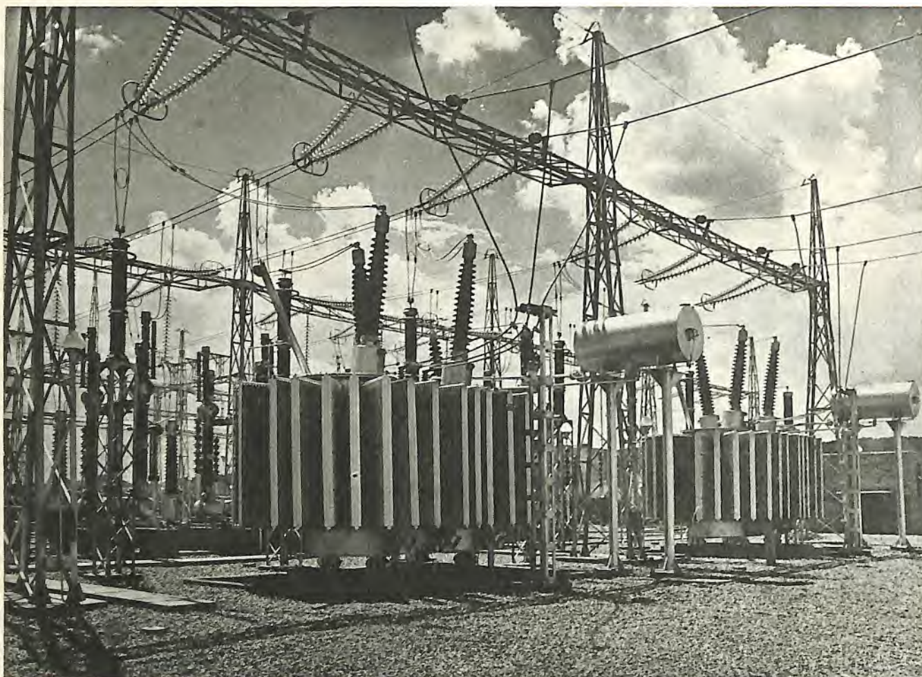
Estação transformadora de energia: símbolo da cooperação do homem para uma vida melhor e mais produtiva.
