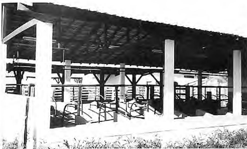
Sala de ordenha desprovida de abrigo para a radiação solar
