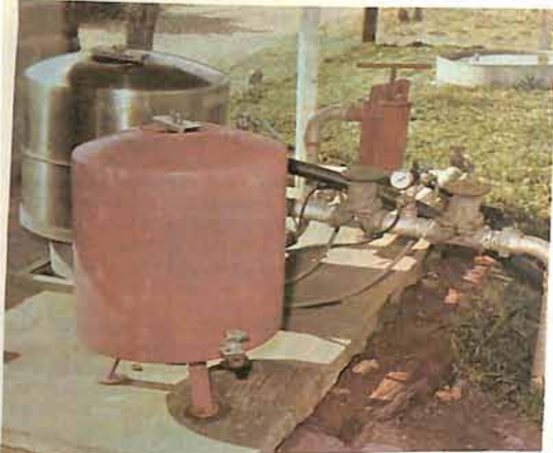
Conjunto de bombas do sistema de irrigação.
