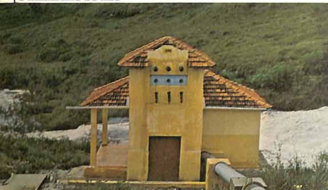
Aproveitando uma das muitas quedas d'água, a Santa Andréa tem sua própria usina de força
