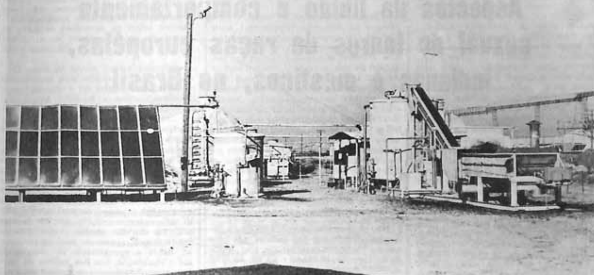
Fase inicial, na qual o esterco é bombeado para dentro do digestor. À esquerda, a unidade de coleta de raios solares.
