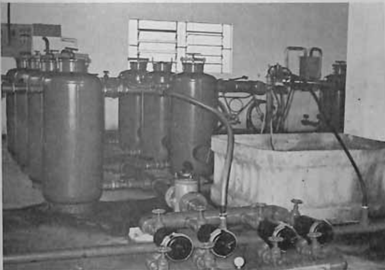
Casa de máquinas para sustentação da irrigação onde a água é filtrada e feita a formulação com adubos para o gotejamento.
