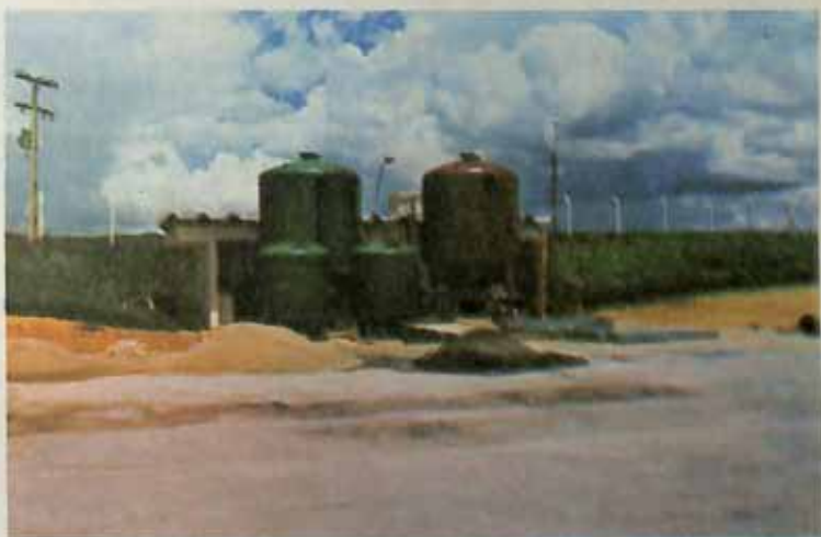
Para o consumo diário de 1 milhão de litros de água, há uma estação para tratamento de 2,5 milhões de litros.
